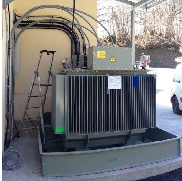
Figure 7. Transformateur 690 V/ 20 kV
