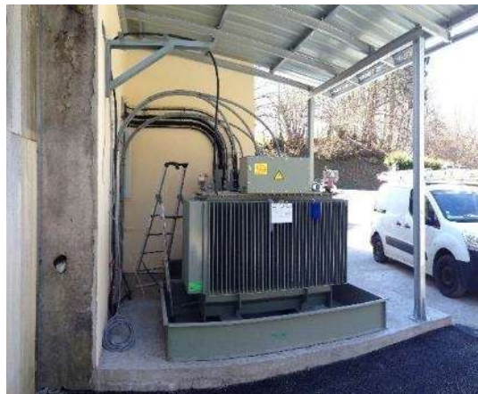
Figure63.. Transformateur 690 V/20 kV
