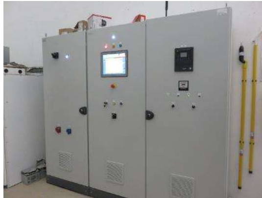
Figure 62. armoires de contrôle commande
