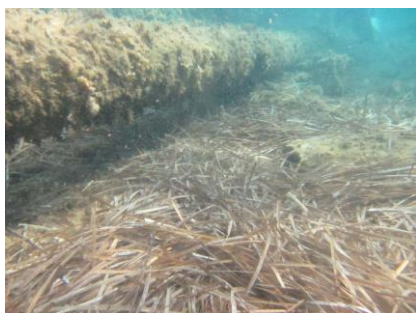
Figure 30 : Emissaire suspendu au-dessus de la matte morte de Posidonie à 6 m de la côte
