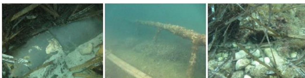
Figure 7 : Photos d'inspection de l'émissaire Renécros
