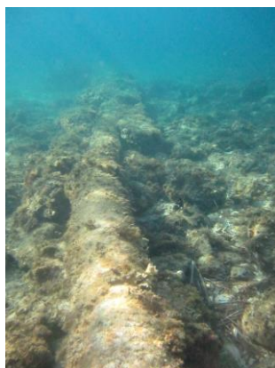
Figure 23 : Enchevêtrements de canalisations à 400 m de l'émissaire, 30 m de la côte. Milieu rocheux.
