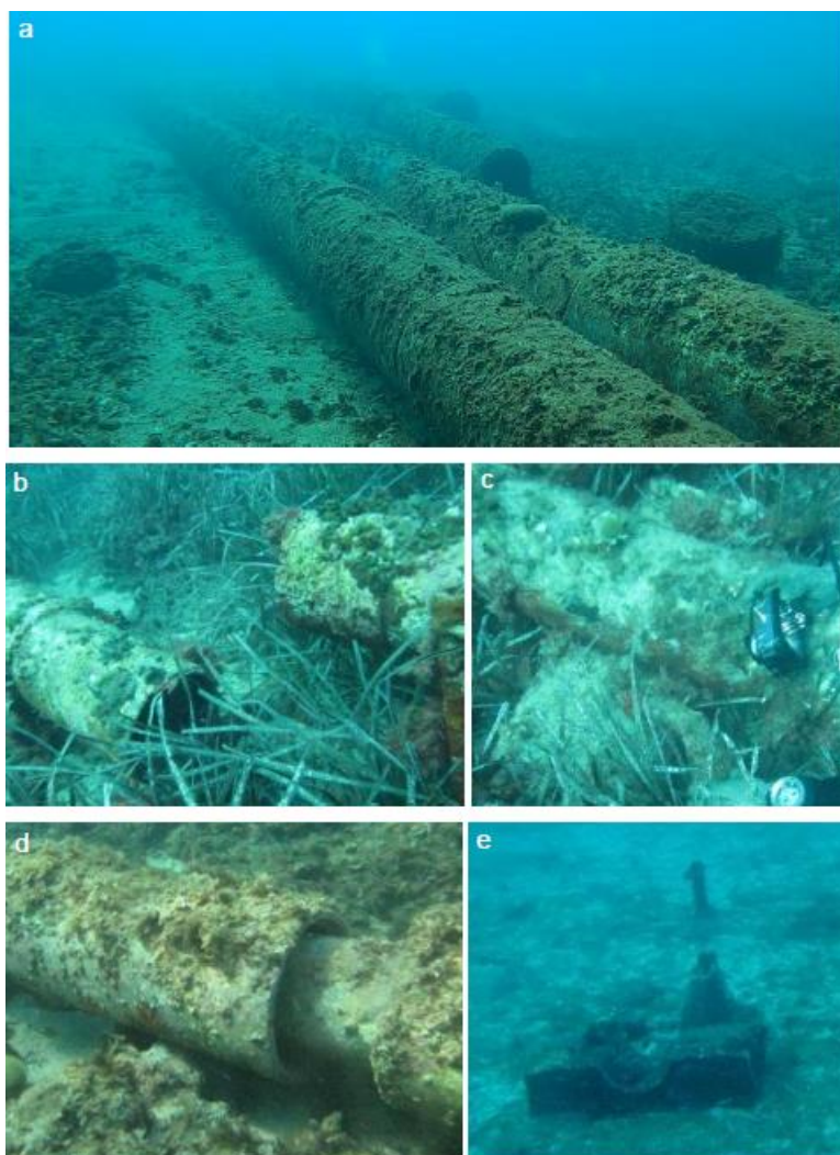
Figure 3 : Exemple de désordre sur l'émissaire Eden Roc : a) anciennes canalisations hors service en parallèle de l'émissaire ; b) rupture de continuité, c) absence de collier ; d) absence de protection ; e) cavaliers en béton sans canalisation
