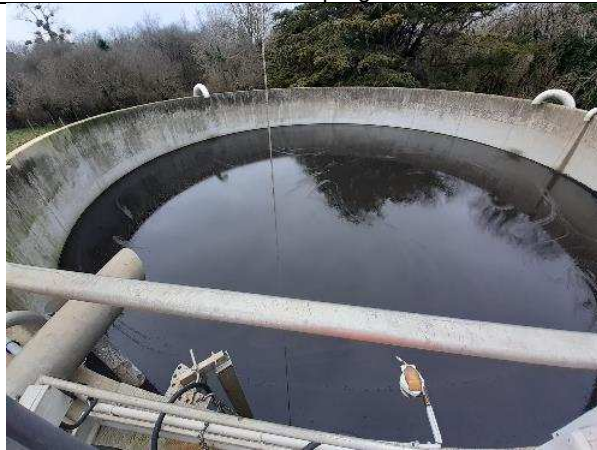
Stockage des boues épaissies
