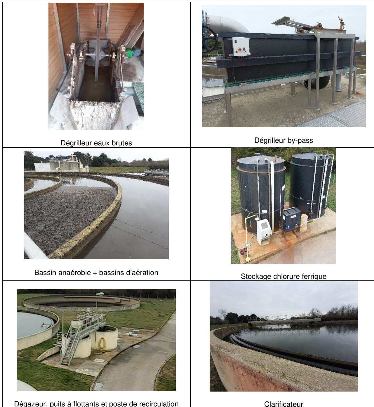
Figure 21 : Photographies de la station d'épuration
