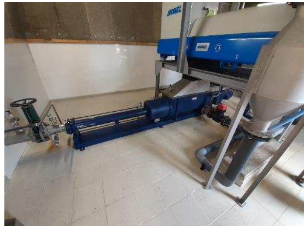
Centrifugeuse + pompe de reprise des boues
