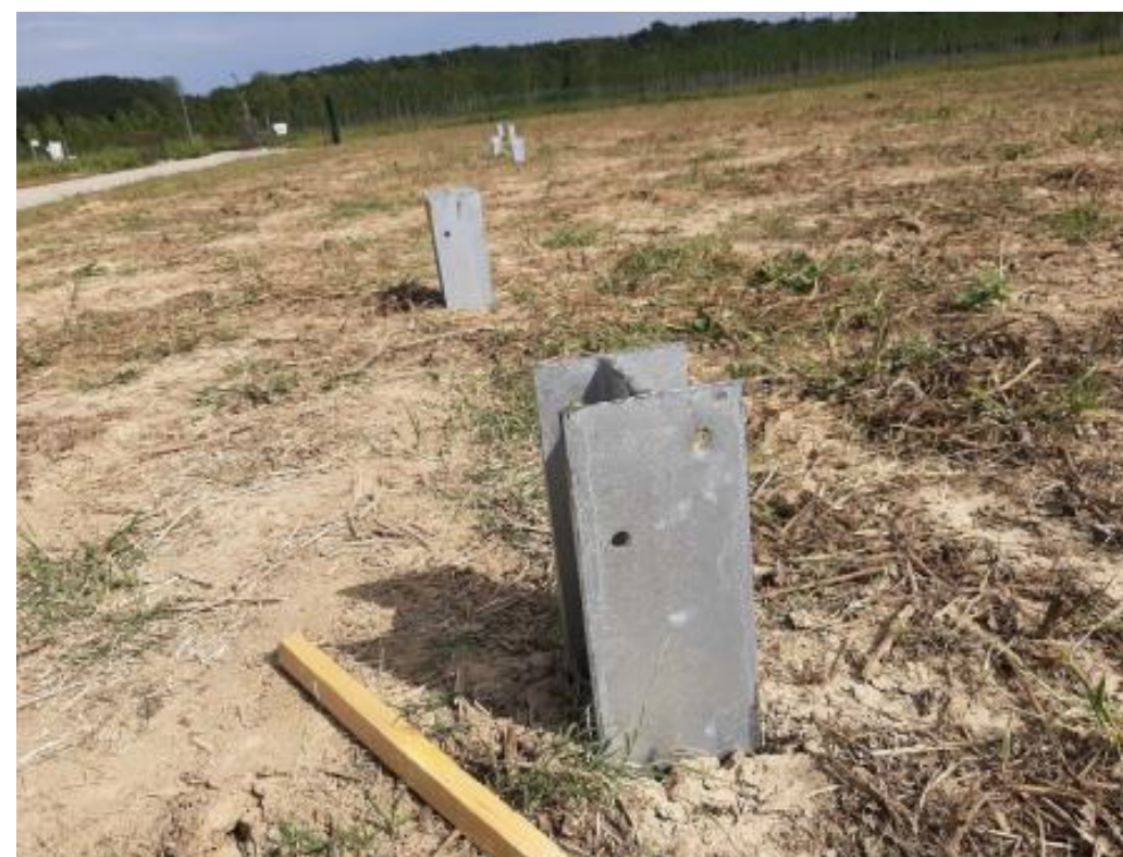
Figure 18 : Pieux battus lors du chantier de la centrale de Samazan (47) (Source : REDEN)
