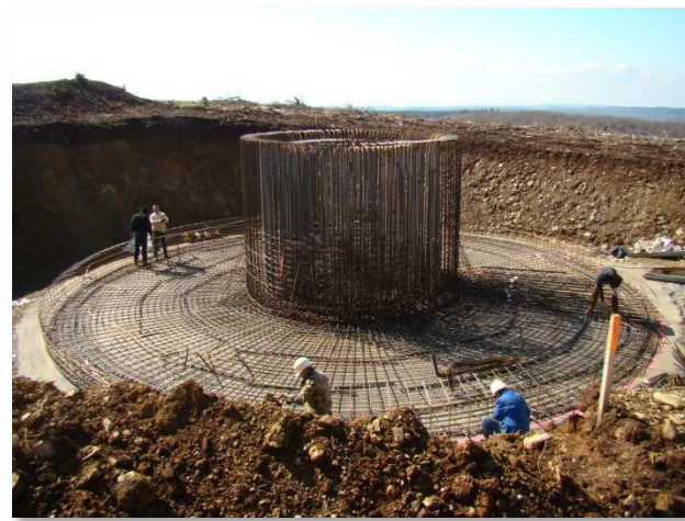
Photo 114 : Armature (Source : VALOREM)
