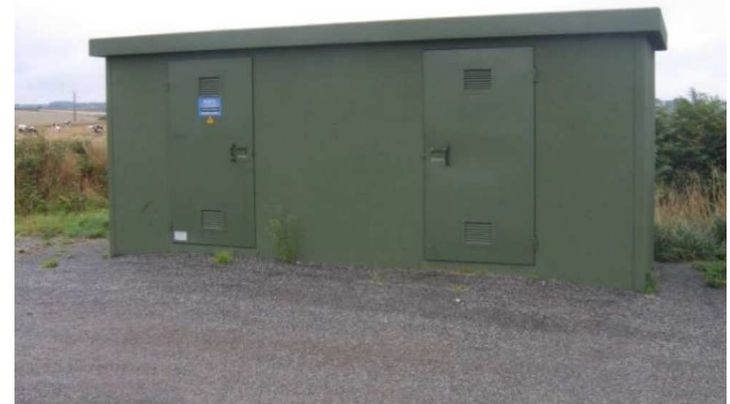
Photo 117 : Exemple de poste de livraison de teinte « vert olive »
