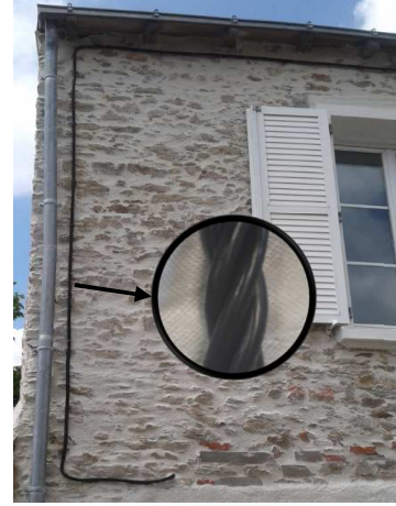
Réseau fils isolés façade BT
