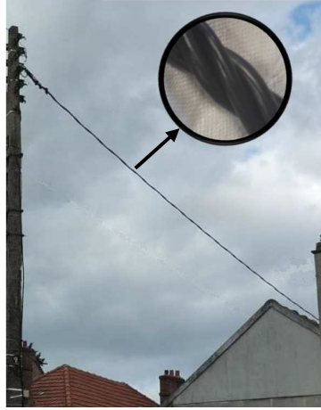
Réseau fils isolés aérien BT
