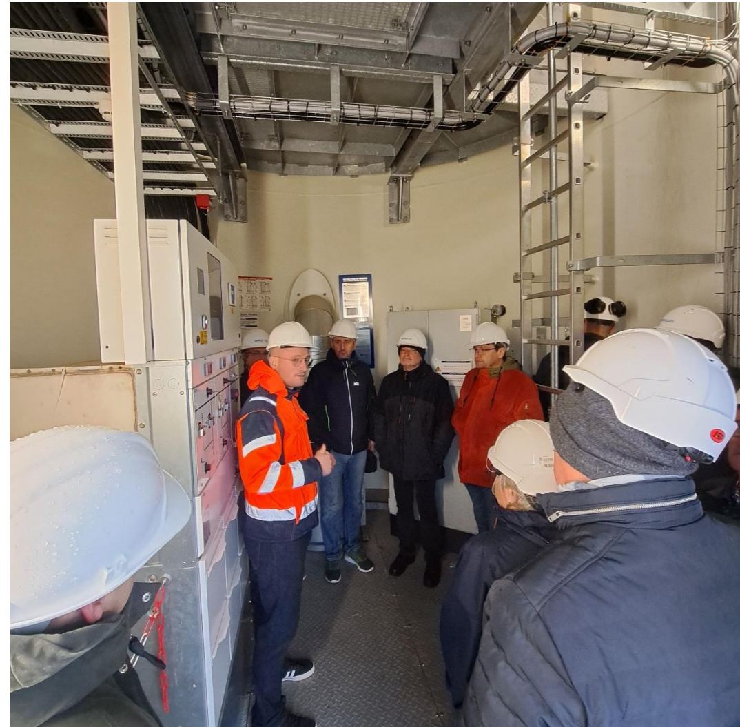
Figure 17 – Visite du pied de l'éolienne par le COSUI
