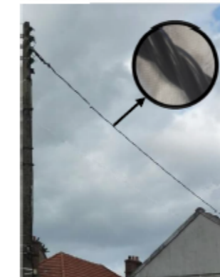
Réseau fils isolés aérien BT
