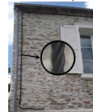
Réseau fils isolés façade BT
