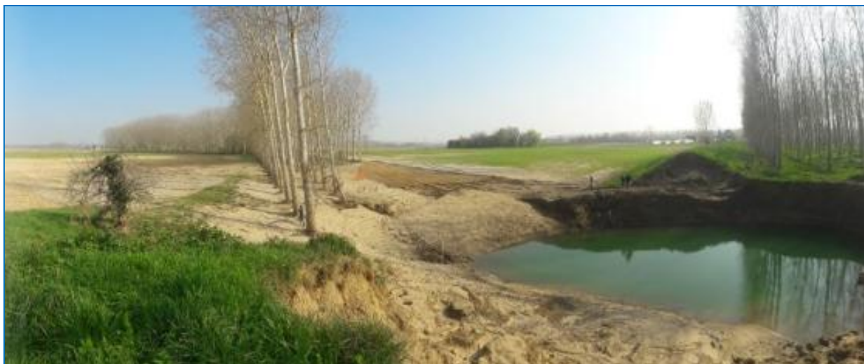
Figure 118 : Exemple de phénomènes de soulèvement hydraulique en pied – Digue de protection le long de la Garonne – Lot et Garonne – Février 2021 – Source : Semofi
