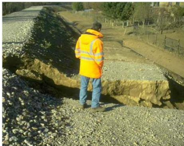
Figure 116 : Renard le long d'une conduite sur la digue de Cuxac-d'Aude lors de la crue de novembre 1999 (source IRSTEA), ayant occasionné un écoulement de plusieurs centaines de litres secondes à travers la digue – brèche en cours de formation
