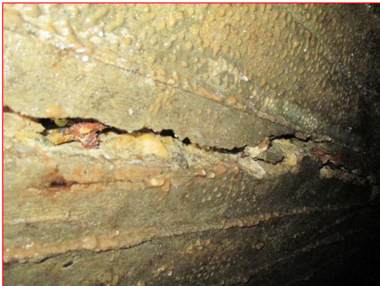
Gros plan de la fissure en toit de dalle.
