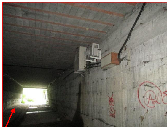
Plusieurs moteurs de climatiseur sont accrochés sur les murs.
