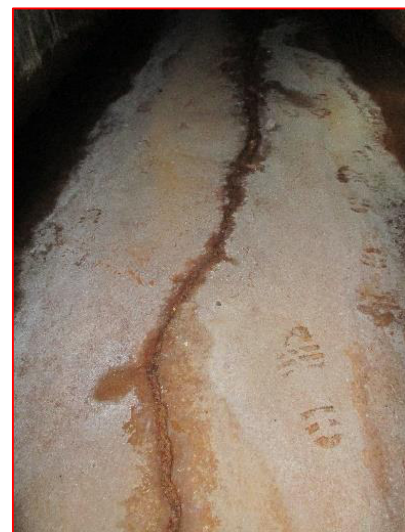
La traverse inférieure de l'ouvrage est également fissurée longitudinalement.
