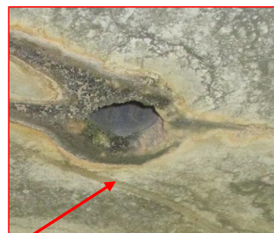
Présence de 3 évacuations de ce type dans la dalle.
