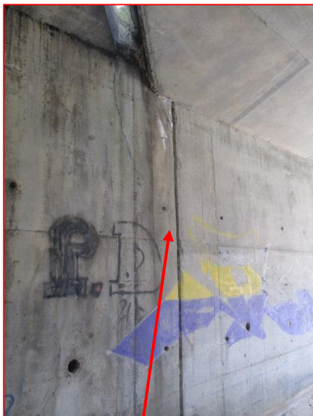
Joint décalé par rapport à celui de la dalle.
