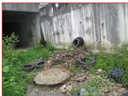
Accumulation de déchets à la sortie de l'ouvrage.
