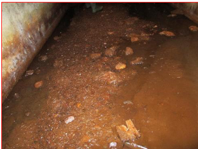
Présence de petits blocs et cailloux mélangés à de la boue et quelques déchets (plastiques, verres...).
