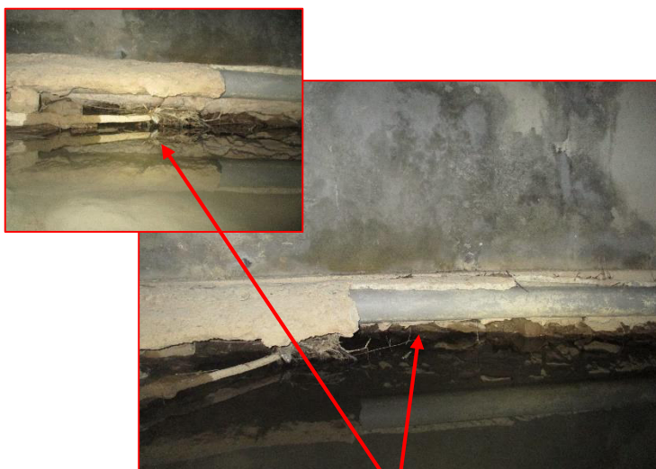
Affouillement sous la canalisation.
