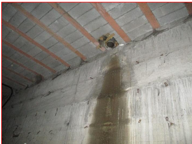
Plusieurs évacuations dans la dalle
