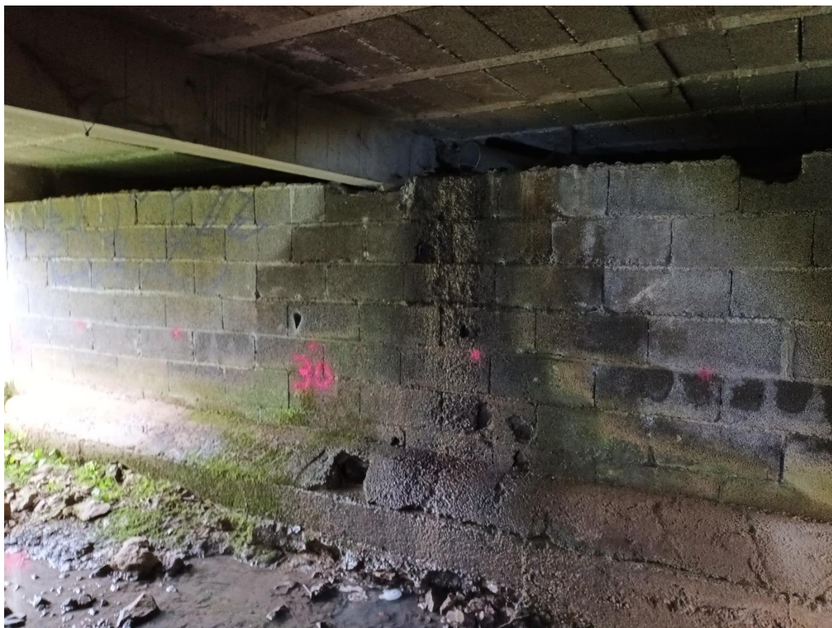
Figure 21 : Erosion et affouillement du mur
