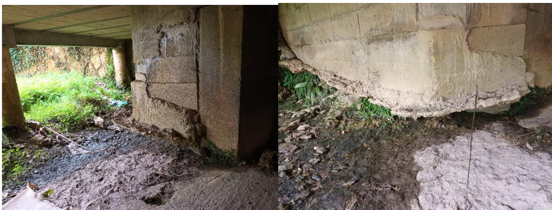
Figure 19 : Affouillements à l'entrée Sud
