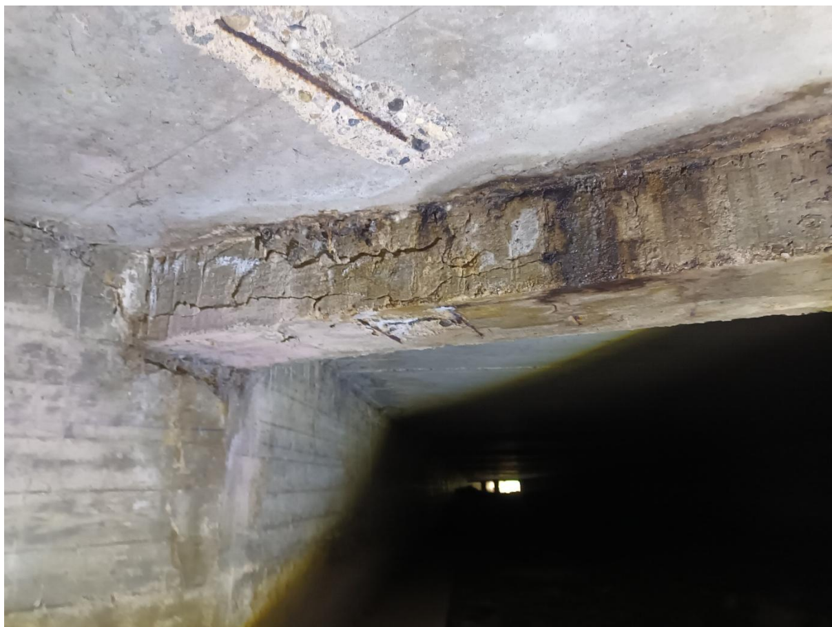
Figure 17 : Longrine présentant des désordres
