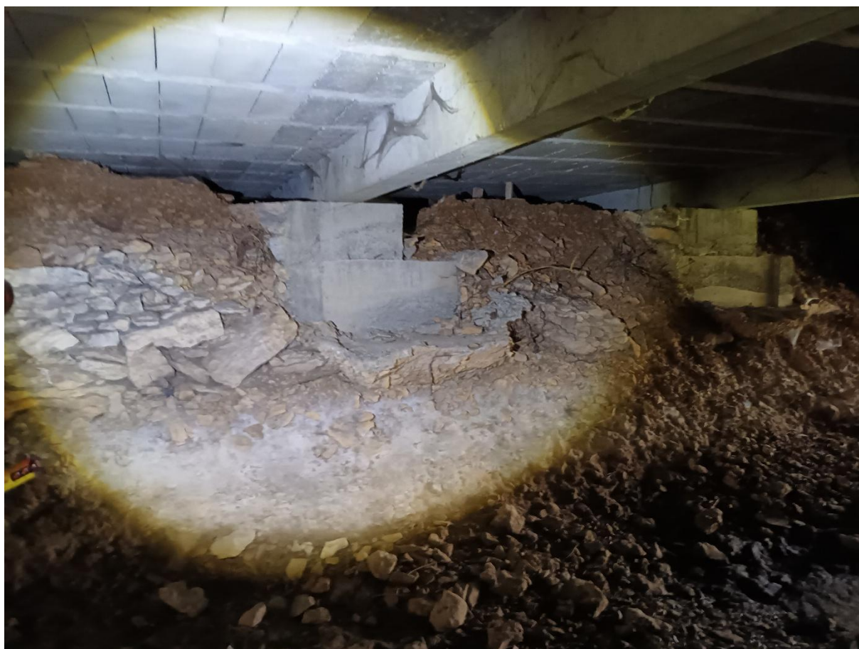
Figure 22 : Exemple d'affouillement des fondations
