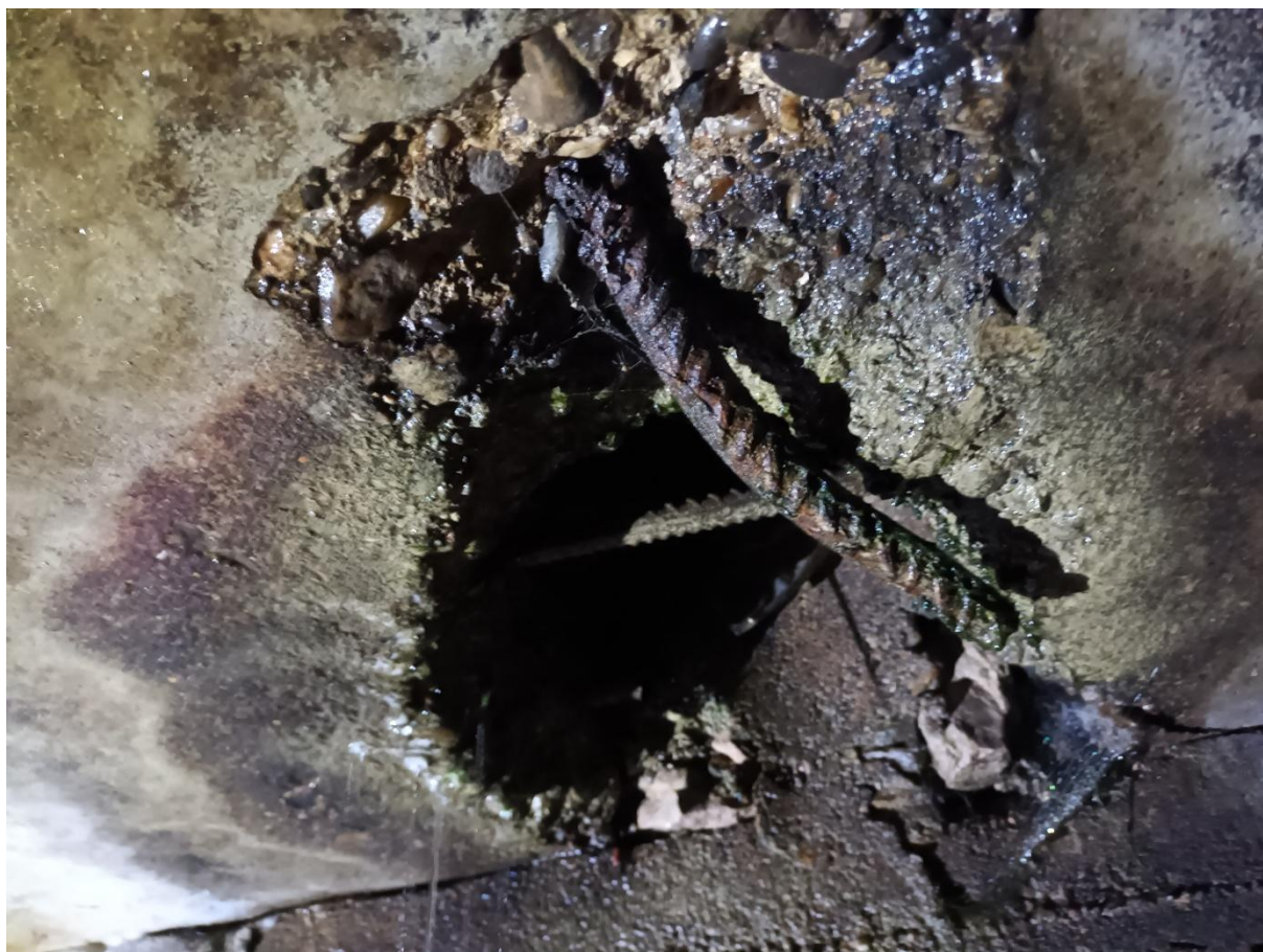
Figure 16 : exemple de perçage présentant des aciers corrodés rencontré lors de l'inspection
