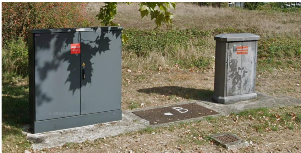
Figure 8: Armoire électrique - Giratoire du roc de l'Agasse
