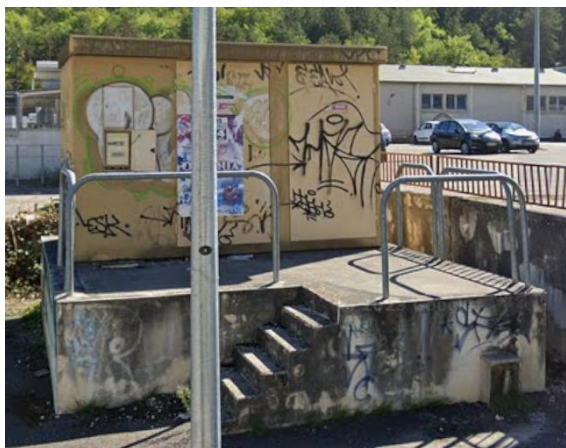
Figure 10: Armoire HTA - secteur Carrefour
