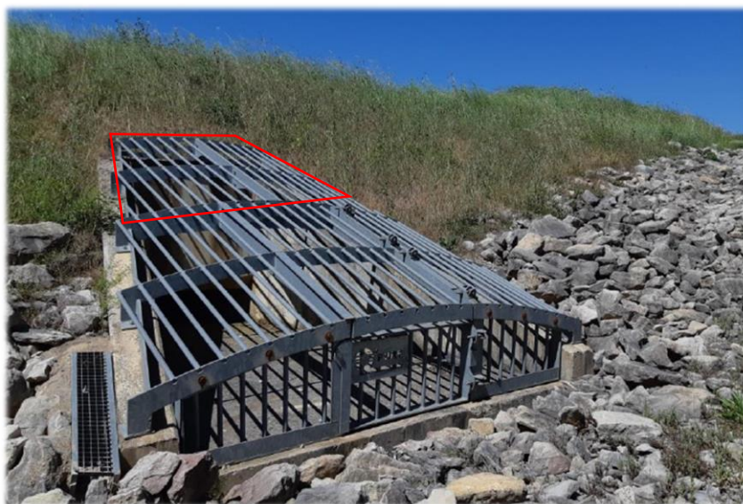
Figure 11 : Exemple d'une grille de protection contre les embâcles
