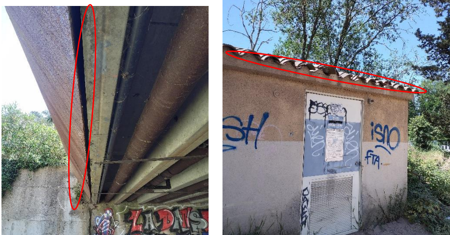
Pont (à gauche) et petit bâti (à droite), gîtes favorables pour les chiroptères fissuricoles (ouvertures cercles rouges)
