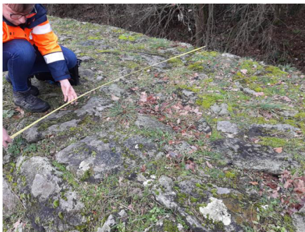
Figure 13 : Léger tassement en crête de digue (Observation 26)
