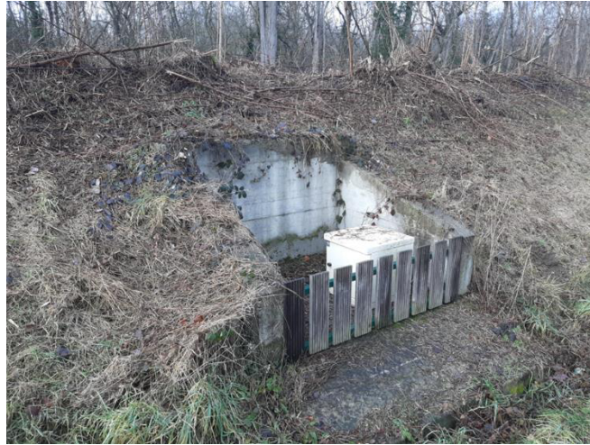
Figure 20 : Ouvrage en béton encastré côté zone protégée (Observation 9)
