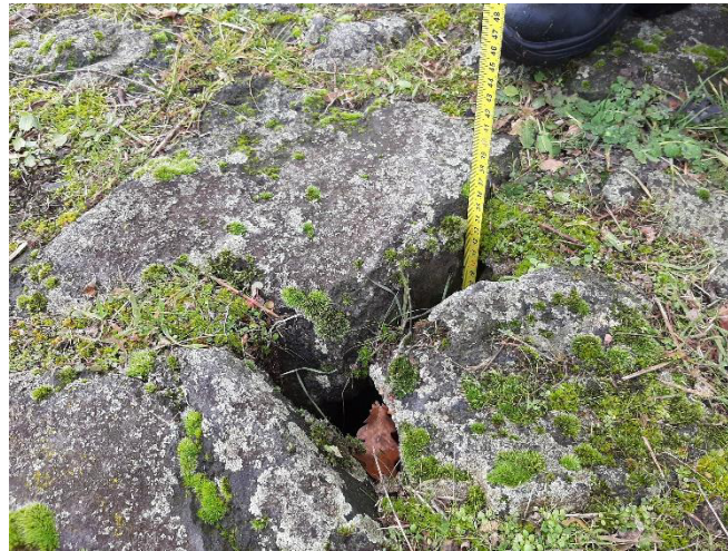
Figure 15 : Cavité en crête de digue (Observation 24)
