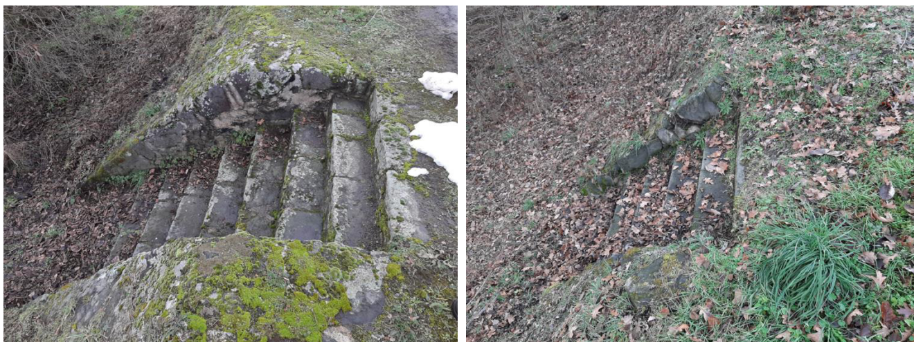
Figure 23 : Escaliers en béton côté cours d'eau (Observations 42 et 45)
