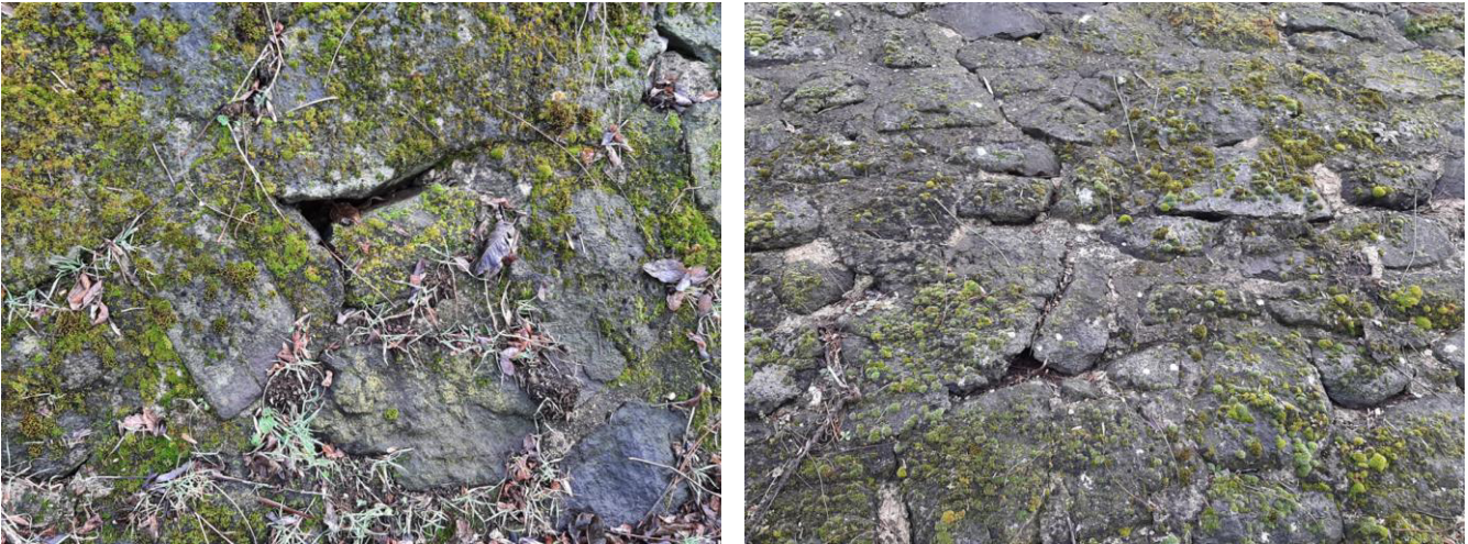
Figure 17 : Déjointements du perré maçonné en partie amont de l'ouvrage
