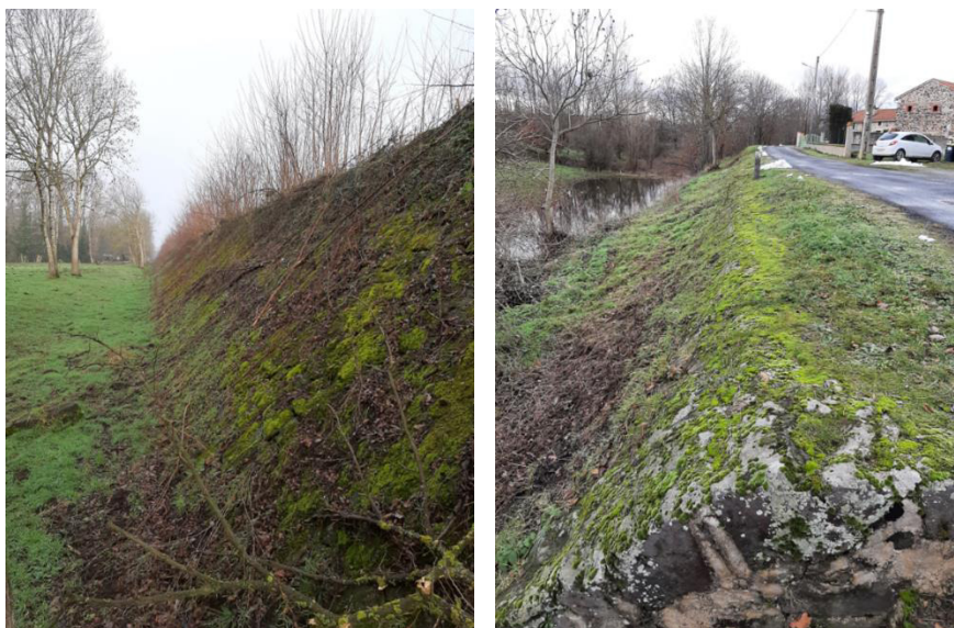
Figure 11 : Présence de mousse sur le perré maçonné de l'ouvrage
