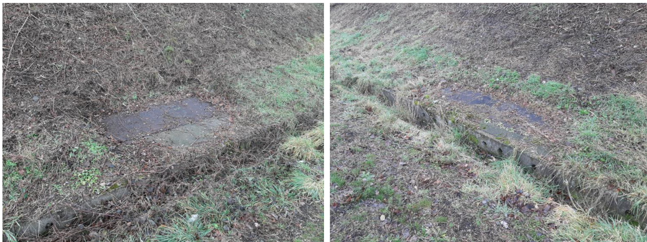
Figure 22 : Regards Telecom présents en pied de digue côté zone protégée (Observations 11 et 12)
