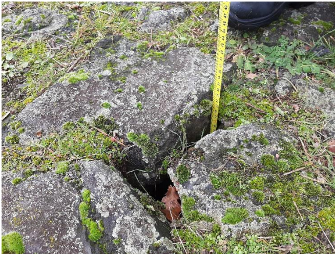
Cavité en crête de digue (Observation 24)
