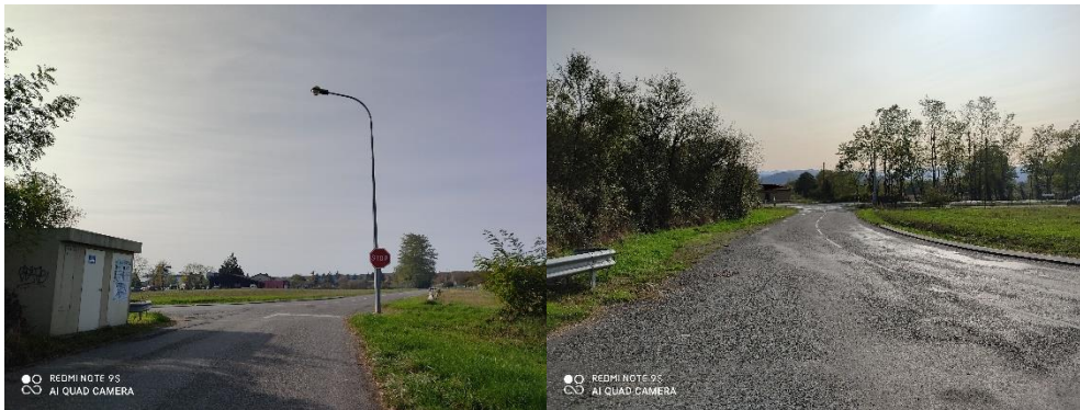
Figure 10 Voiries "Saint-Pé" - Mauvais état - Iter 2020
