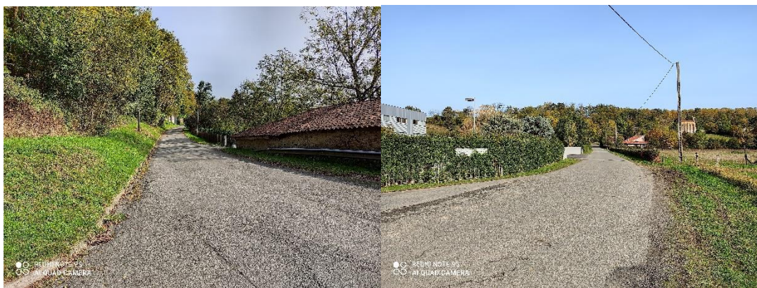
Figure 7 Route du Père Marie Antoine et Voie de la Chapelle - Mauvais Etat – Iter 2020
