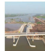
Au Vietnam, après plusieurs années d'études, CNR supervise en association avec Egis et son partenaire vietnamien (VTC) les travaux de construction d'un canal de jonction entre deux bras du fleuve Rouge équipé d'une écluse à grand gabarit et d'un viaduc routier.
