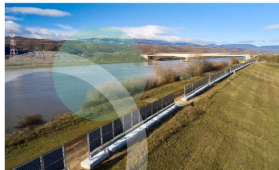
Zone puissance de 104 MWc et lag de 350 m, le démonstrateur photovoltaïque de la digue de Sablons (38) mis en service en 2021, en partenariat avec le CEA-INES 23 et Supergit Institut.
