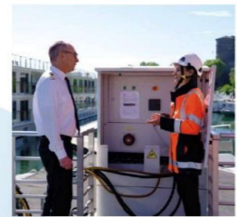
Borne haute tension pour l'alimentation électrique des bateaux à péage de Tournay-sur-Rhône (07)
