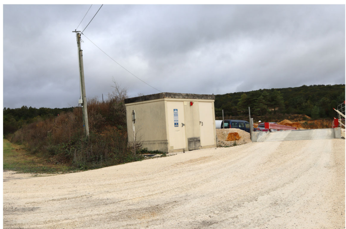
Transformateur électrique au niveau de l'entrée du site
