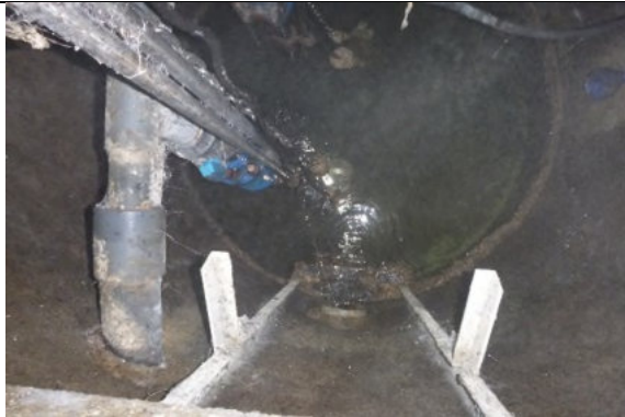
Infiltrations dans le PR (paroi non étanche) PR Les Proires 2 La Brée-Les-Bains (Petits Marais)
