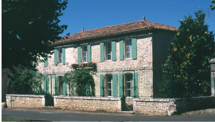
Sur une maison saintongaise, le piquage de l'enduit de façade est un non-sens technique autant qu'esthétique, Saint-Sornin.
