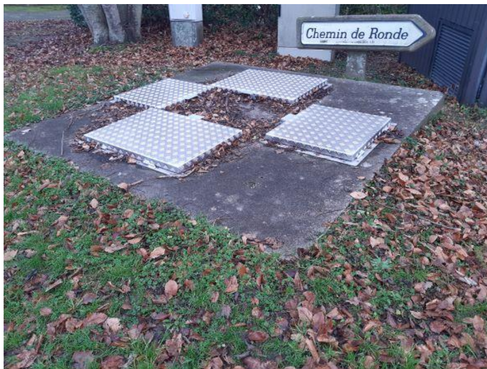
Figure 52 : Prise de vue d'un poste de refoulement enterré (aperçu des trappes d'accès).
