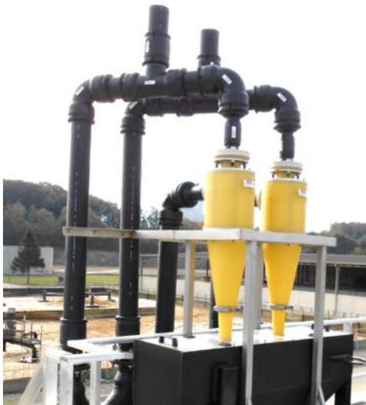
Figure 51 : Exemple d'installation d'hydrocyclone (Cideral 22)
