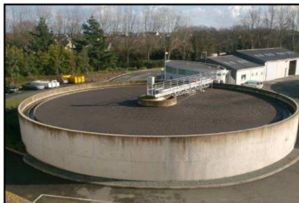
Figure 12 : Photographie d'un des clarificateurs
