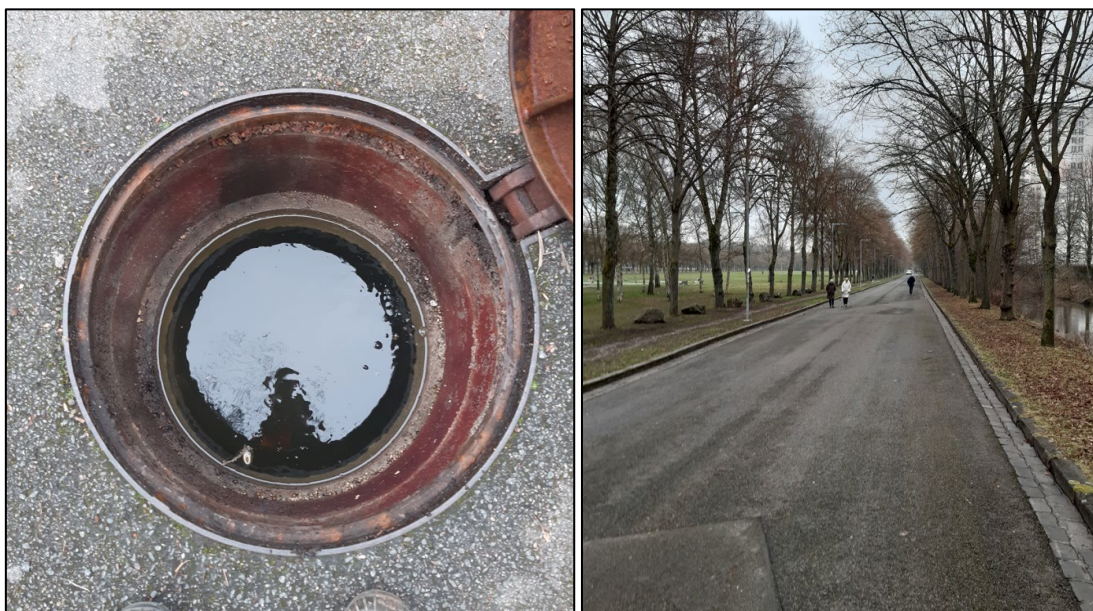
Réseau de drainage allée de Tivoli
