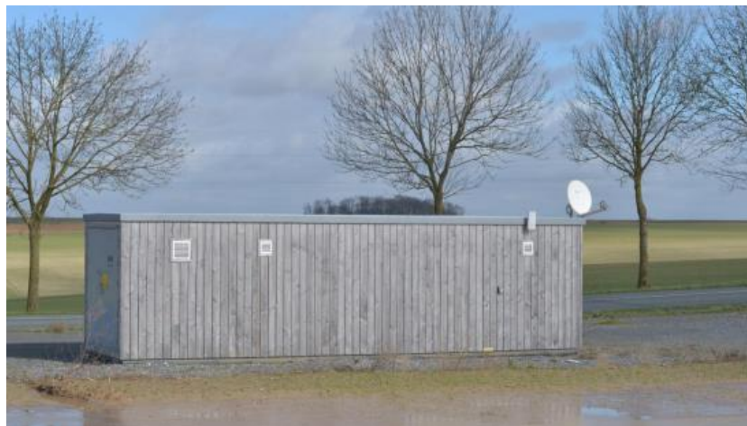
Exemple de poste de livraison avec bardage bois vertical (source : ATER Environnement, 2022)
