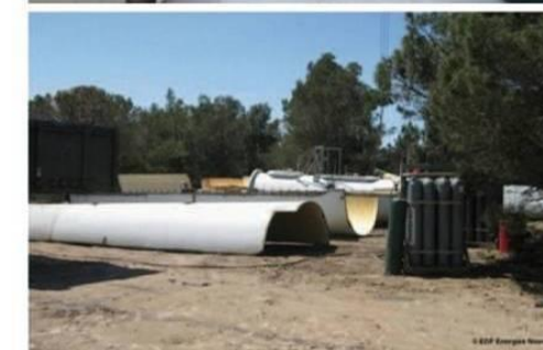
7 - Déchargement et découpe au chalumeau sur la plateforme de découpe avec mise au format pour évacuation vers les filières de gestion des déchets
