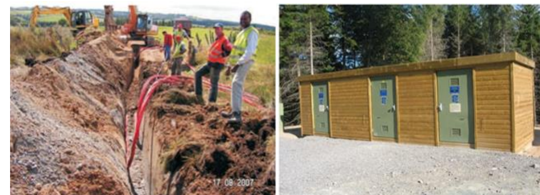
Photographie 7 : Déroulage et pose des câbles (à gauche), poste de livraison (à droite) (Source : EDF Renewables)
