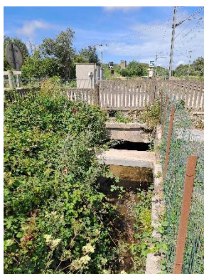
Photo 8 : Vue de la station depuis l'aval vers l'amont
