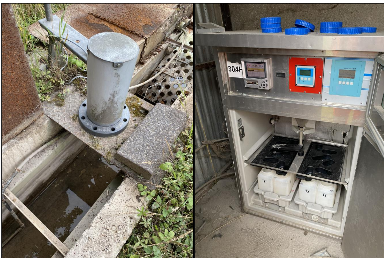
Photo 9. À gauche : rejet des eaux d'exhaure à débit limité (canal Venturi et débitmètre) dans le fossé SNCF. À droite : système de prélèvement automatique des eaux avant rejet (source : Stinkal)
