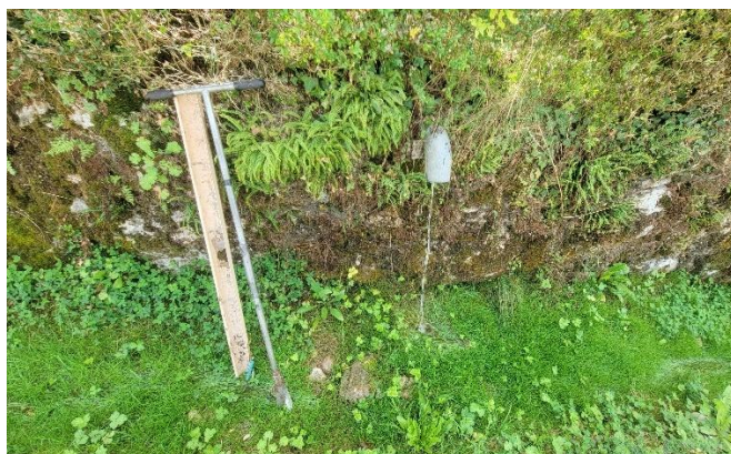
Sortie de drain coulant en continu
