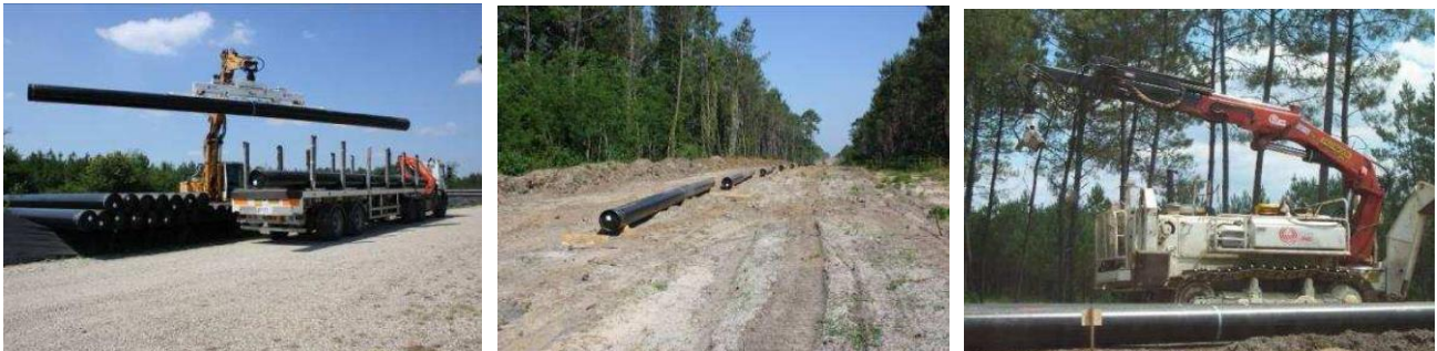
Figure 41 : Bardages des tubes
