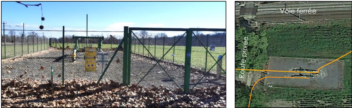
Figure 5 : Poste de sectionnement LABARTHE-INARD
