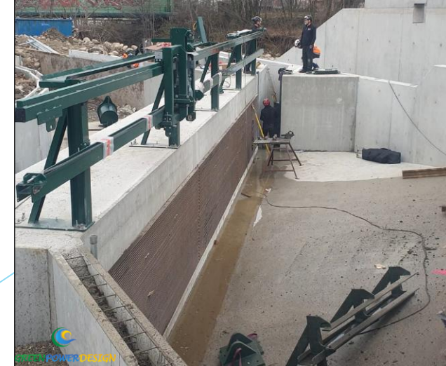
Plan de grille ichtyocompatible orienté installé sur le Vicdessos
