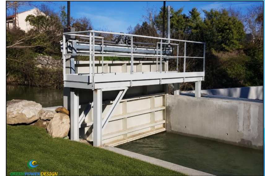
Vannage de prise d'eau installé sur la Louge
