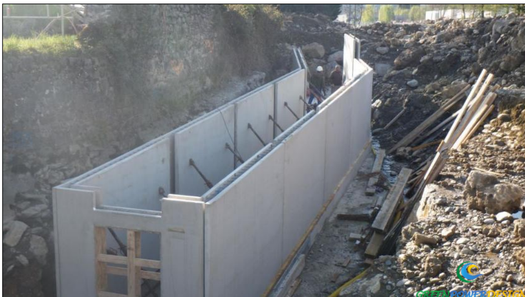
Figure 35 : Exemple de construction de passe à poissons en éléments préfabriqués Rivière Salat (09) Etudes et maîtrise d’œuvre Green Power Design
