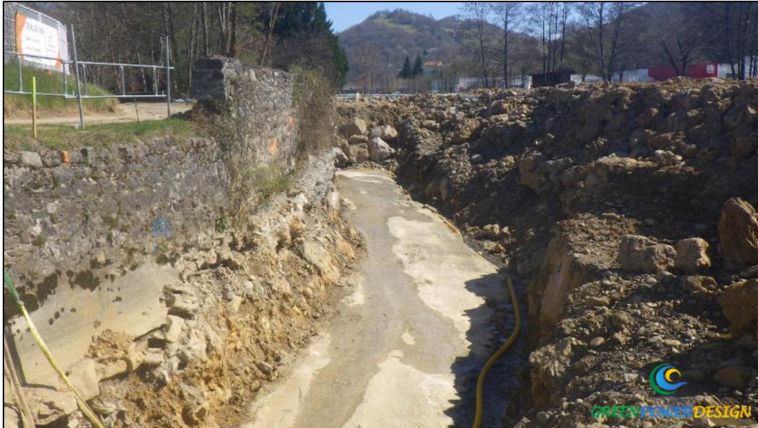
Figure 34 : Exemple de terrassement de passe à poissons Rivière Salat (09) Etudes et maîtrise d’œuvre Green Power Design
