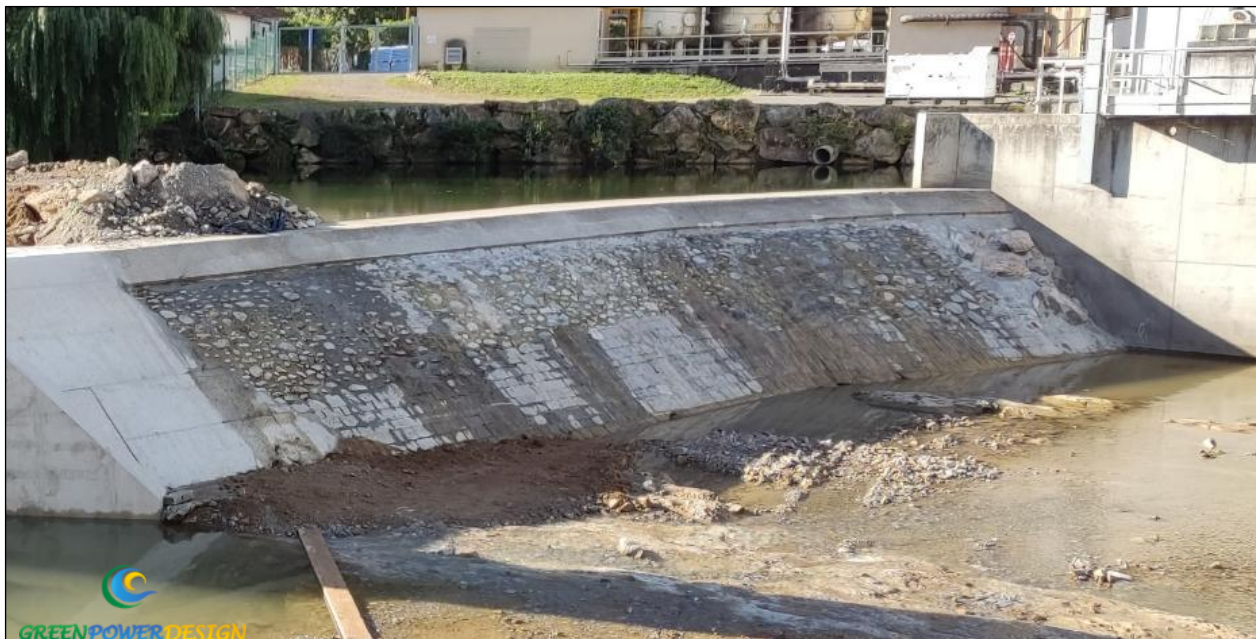
Figure 12 : Barrage en cours de rénovation (rivière Salat – Etude et MOE Green Power Design)
