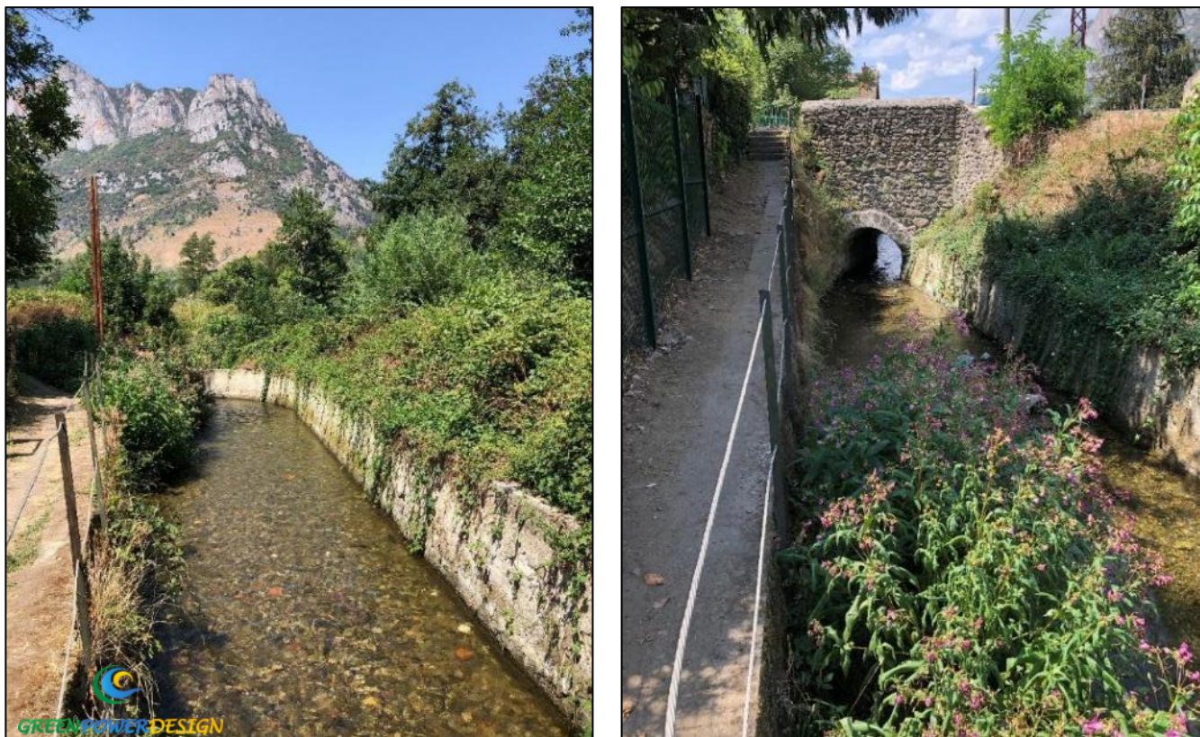
Figure 6 : Vue de la partie amont du canal (à gauche) et de la traversée de la RD120 (à droite)
