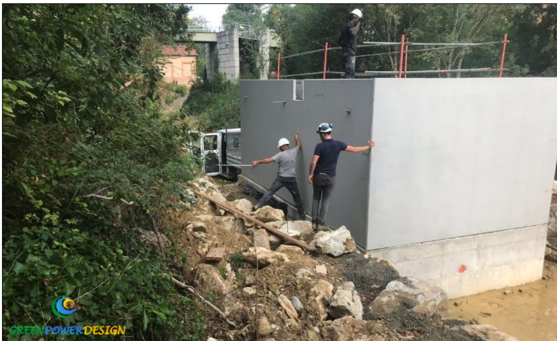
Figure 30 : Pose de voiles préfabriqués d'une chambre d'eau de turbine DIVE La Louge (31) - Etudes et maîtrise d'œuvre Green Power Design
