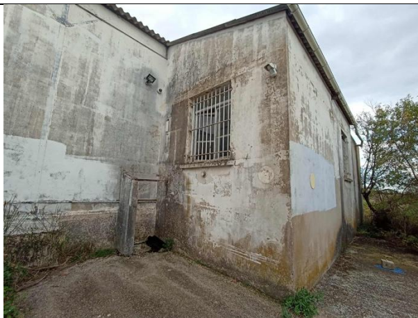
Vue latérale du bâti où la toiture semble inaccessible et fenêtres condamnées et/ou grillagée
