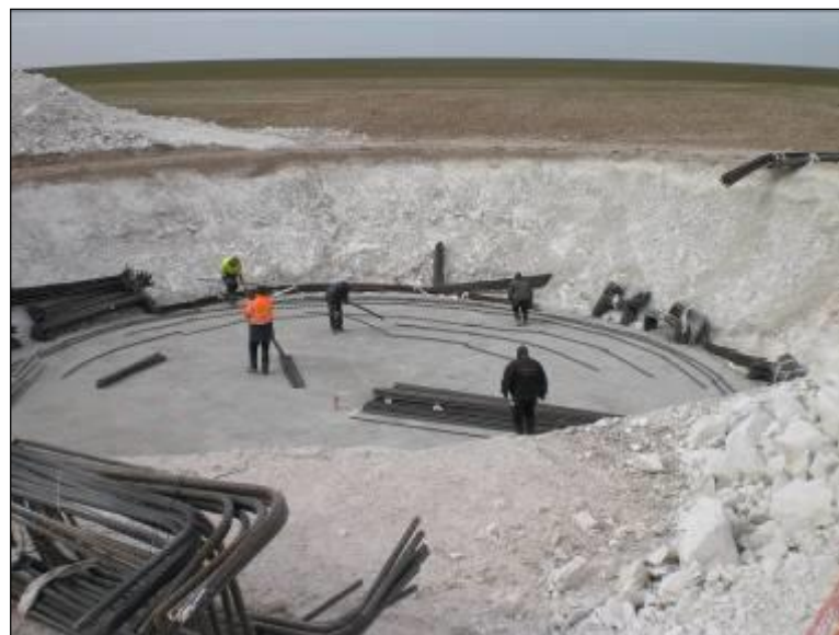
Photo 123 : Exemple de fondations à remettre en état
