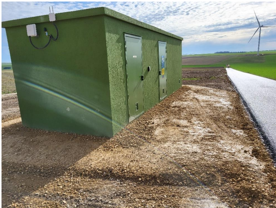
Illustration 16 : Poste de livraison du parc éolien de Nongée (08)
