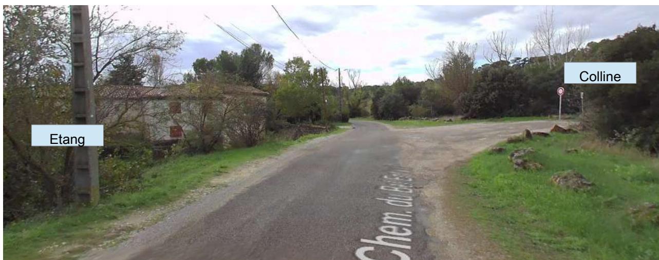
Vue de l'absence de noue et du pendage du chemin de Bel Enfant (partie Nord)
