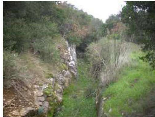
Effondrement bloquant les écoulements juste après l'ouvrage
