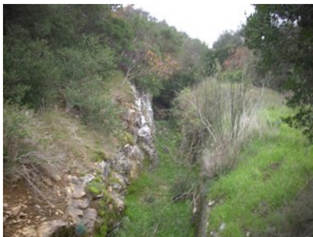
Effondrement bloquant les écoulements juste après l'ouvrage
