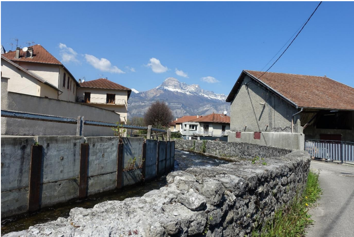
Mur en pierre sèche le long du Ruisseau du Mont, Rue des Eaux Claires
