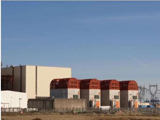
Diesels d'Ultime Secours (DUS) de 3 MWe
