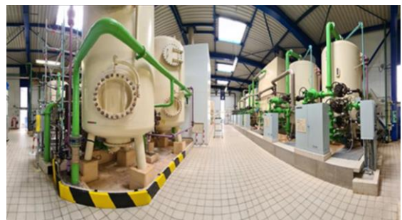
Station de déminéralisation de la centrale de Dampierre-en-Burly © EDF
