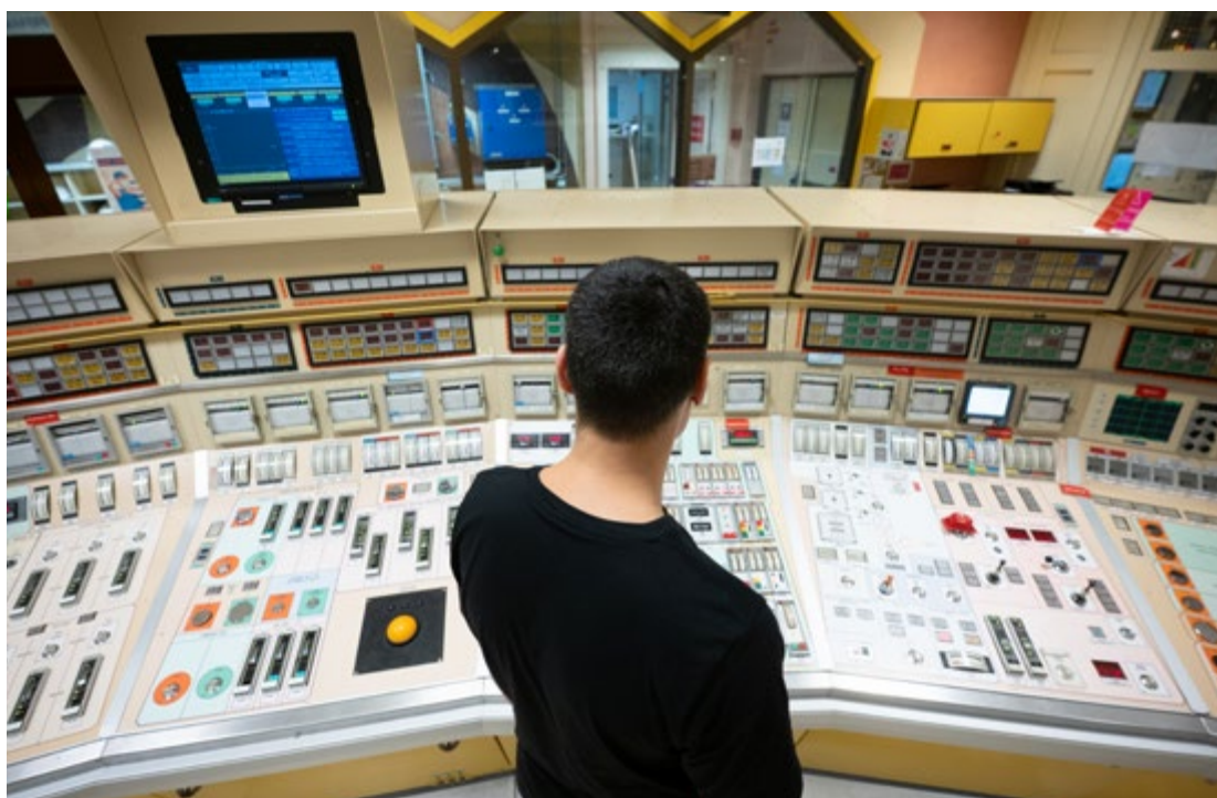
Figure 21. Salle de commande d'un réacteur 900 MWe (Copyright EDF / DAMPIERRE / Romain BEAUMONT)
