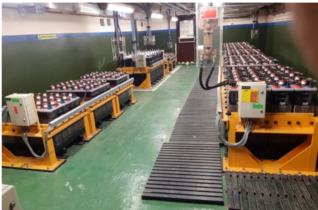
Figure 8. Photo des locaux contenant les batteries
