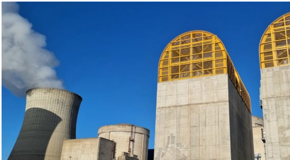
Diesels d'ultimes secours (DUS) des réacteurs n°3 et n°4
