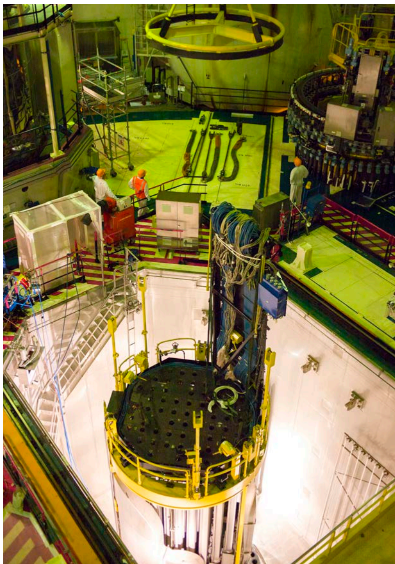
Pose du couvercle de cuve du réacteur au Centre Nucléaire de Production d'Électricité de Cruas-Meysses.
