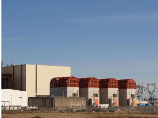
Diesels d'Ultime Secours (DUS) de 3 MWe
