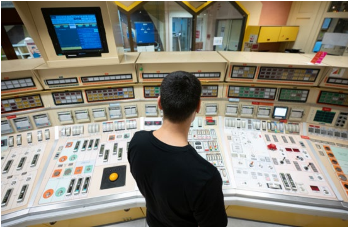
Figure 21. Salle de commande d'un réacteur 900 MWe (Copyright EDF / DAMPIERRE / Romain BEAUMONT)
