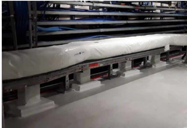
Figure 6. Exemple de protection de chemin de câble
