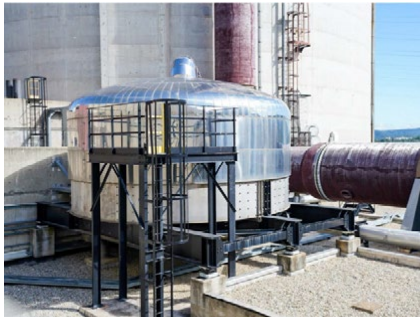
Figure 15. Photo du dispositif d'éventage et de filtration de l'enceinte (filtre U5)
