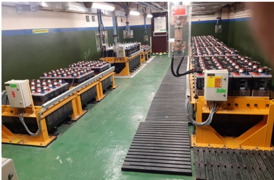
Figure 8. Photo des locaux contenant les batteries
