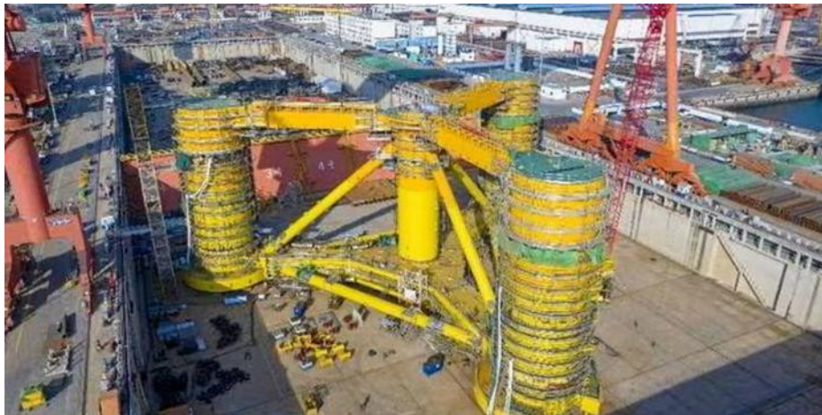
Figure 3-1 : Exemple de construction flottante à l'intérieur d'un bassin de radoub. Source : upstreamingonline.com
