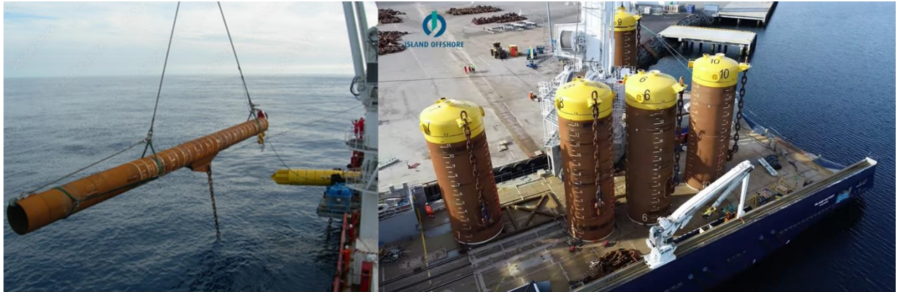
Figure 2-3 : Système d'ancrage – pieux « enfoncés » (à gauche) et pieux « à suction » (à droite)
