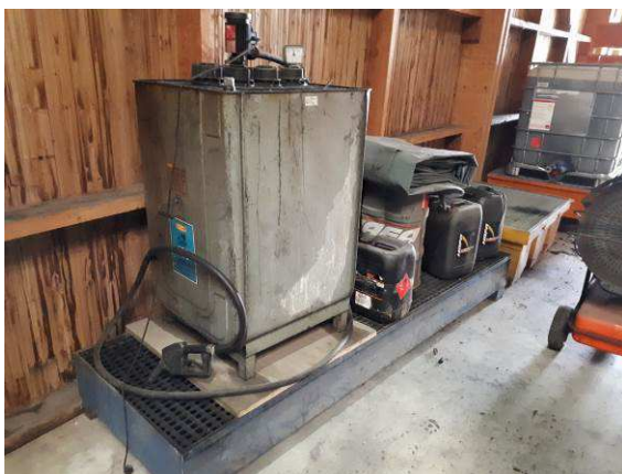
Stockage FOD pour chauffage bâtiment autoclave
