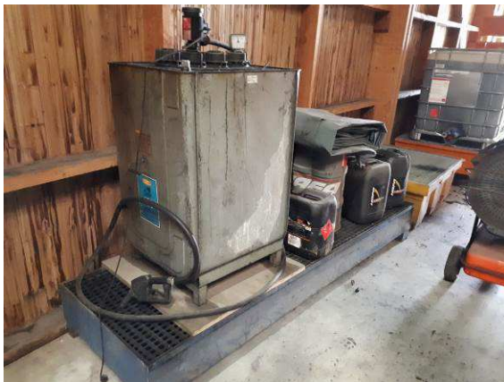
Stockage FOD pour chauffage bâtiment autoclave
